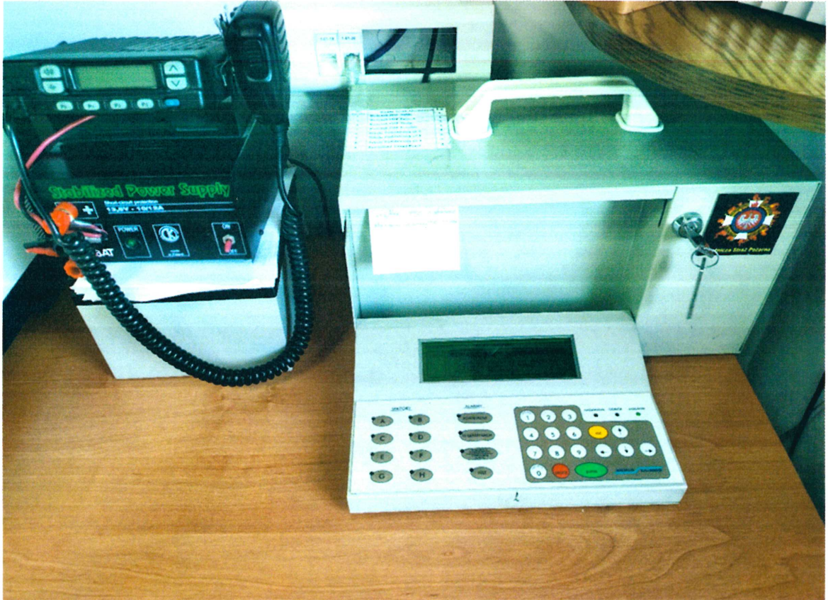
Centrala systemu alarmowania w Gminnym Centrum Zarządzania Kryzysowego.
